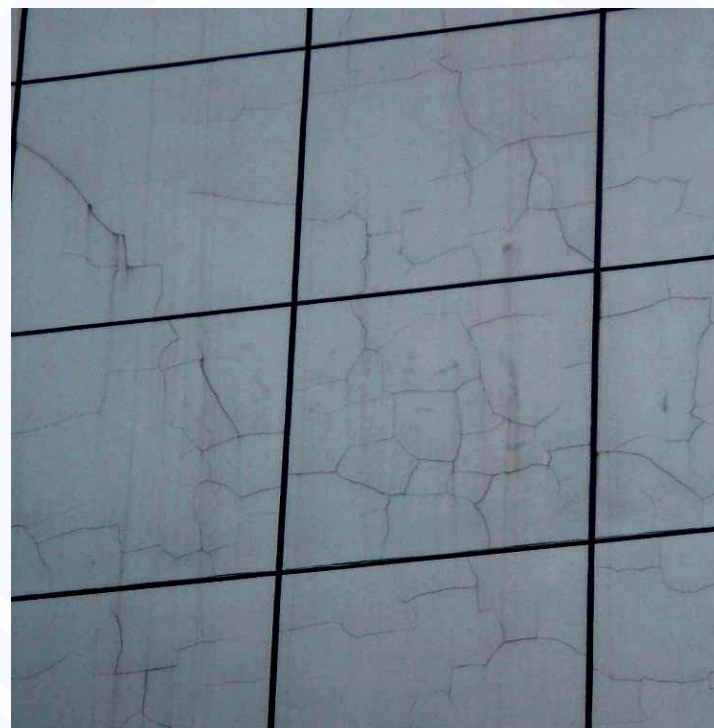
水泥砂浆和腻子层后期干燥收缩裂缝
