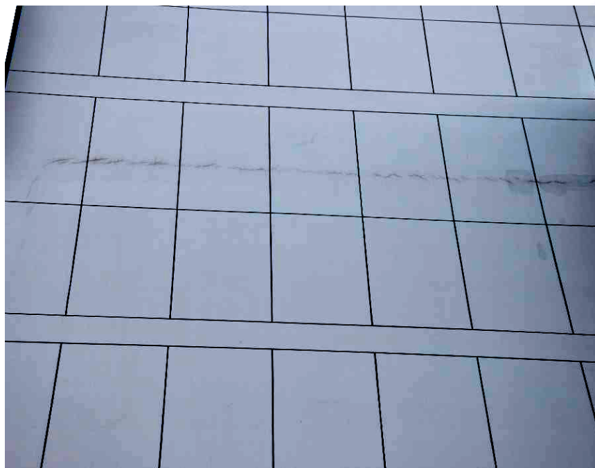
新建建筑的结构性裂缝(混凝土与砌筑砖墙间)
