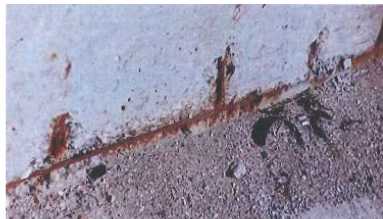
钢筋严重锈蚀
