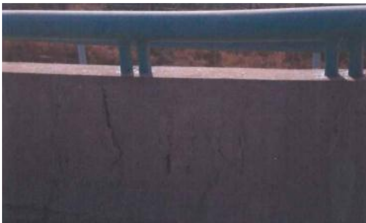
护栏底座顺筋开裂
