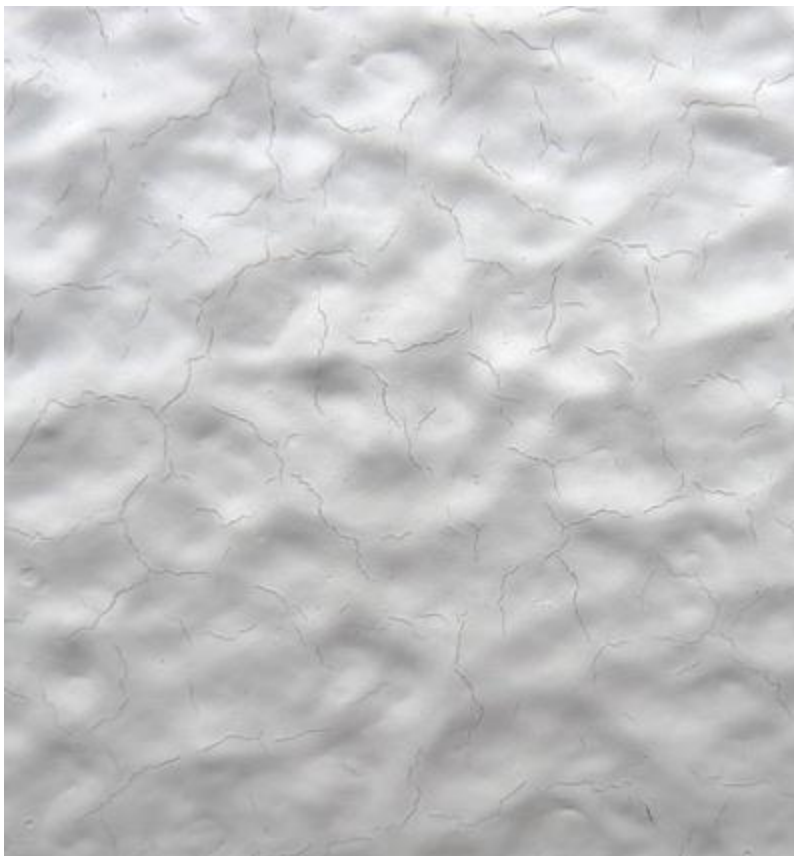
弹性中层拉花+ 普通外墙涂料 经过冷热循环测试后表面开裂
